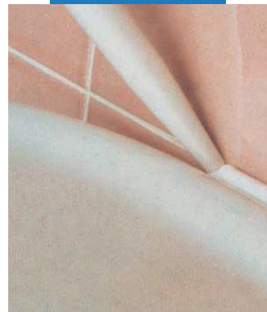
Tesnenie škár v styku so sanitárnym zariadením.
