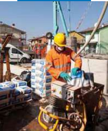
Príprava a čerpanie zmesi Novoplan Maxi s použitím strojného zariadenia s kontinuálnym miešaním
