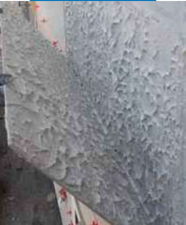
Vysoká zmáčavosť medzi zadnou stranou obkladového prvku a podkladom
