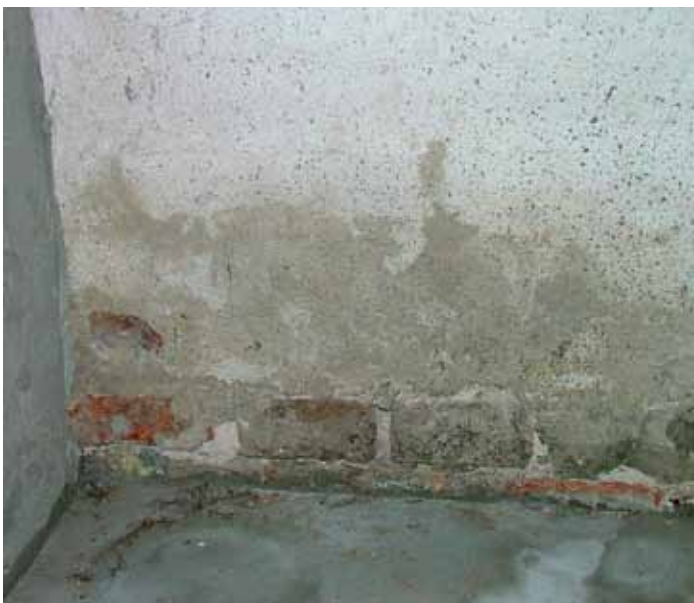
Poškodenie vlhkosťou v suteréne
