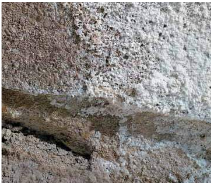
Poškodenie soľou pôsobiacou v hline
